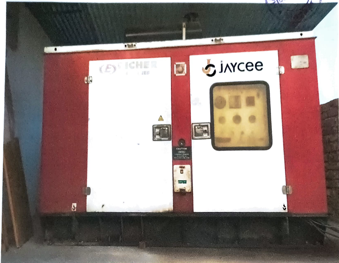
Fig: 4 Diesel Generator
